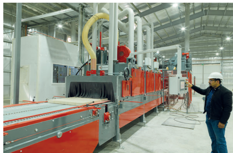
Die Curling-Anlage verfügt über eine eigene Steuerung mit Bedienpanel mit Visualisierung.
