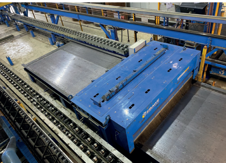
Устройство очистки поддонов
