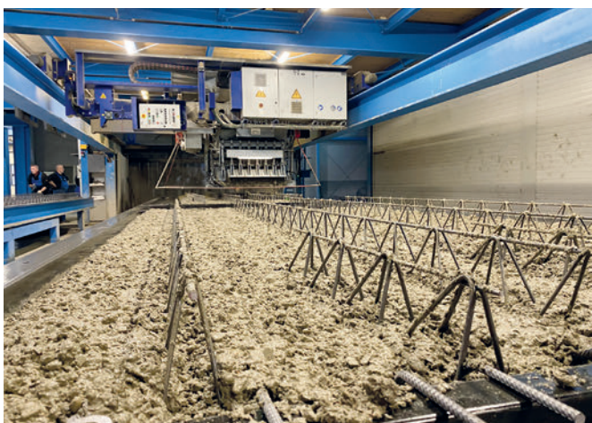
Stazione di betonaggio
