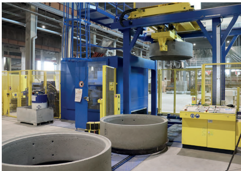
Vista della stazione di pallettizzazione con l'adiacente stazione di pulizia, chiusa in blu, e la successiva stazione di oliatura dei fondelli
