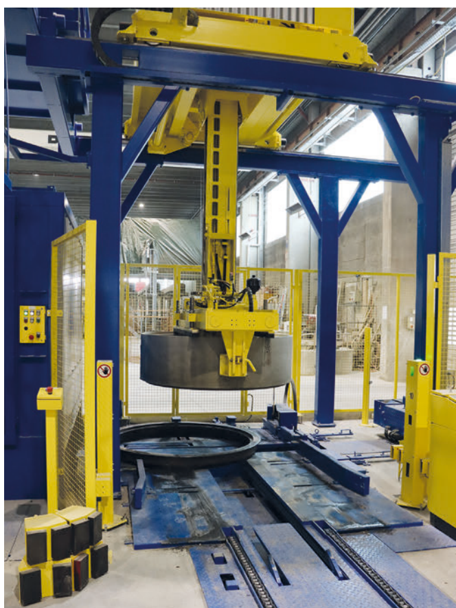
Una vez que el manipulador haya elevado el componente para pozos y lo haya soltado del encofrado anular, se introduce directamente en la estación de limpieza.
