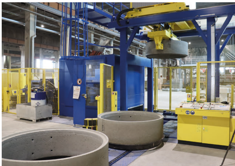
Imagen de la estación de paletizado con la unidad de limpieza azul encerrada colindante y la posterior estación de lubricación de encofrados anulares
