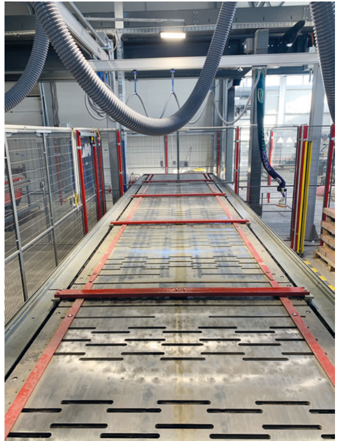
Transportador especial de la línea de recubrimiento
