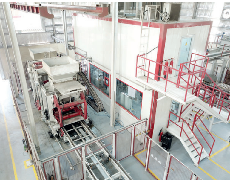
Сердцем новой производственной линии является бетоноформовочная машина Multimat RH 1500-4
