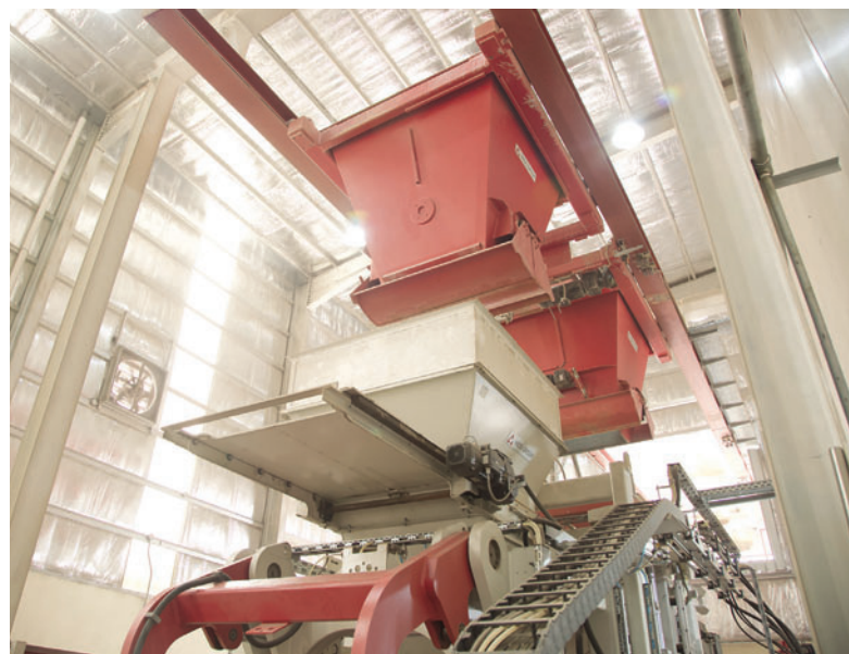
Двойной ковшовый конвейер передает основной и лицевой бетон в соответствующие бункеры бетоноформовочной машины
