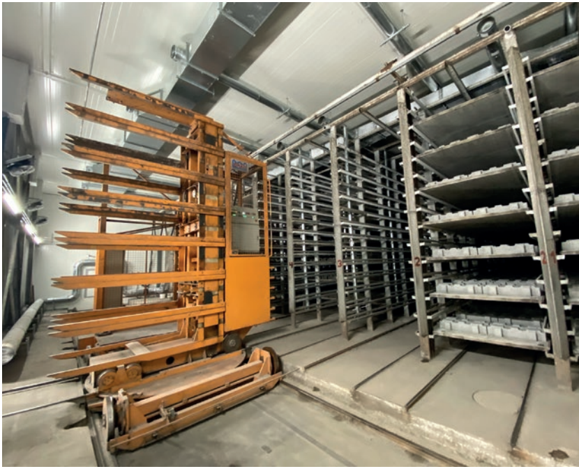
Widok na komorę dojrzewania z systemami rur Quadrax na suficie i przy posadzce.
