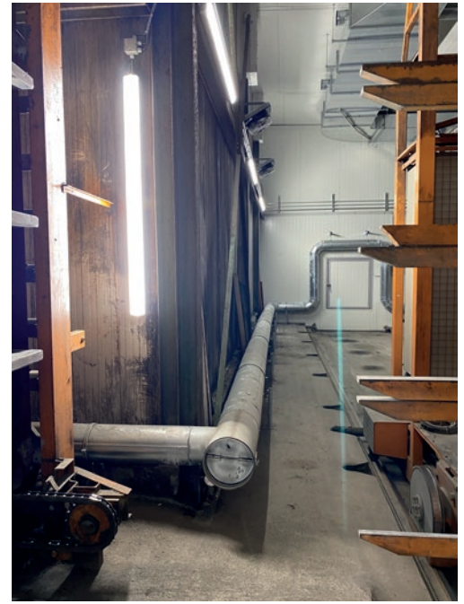
W tle widoczne izolowane drzwi serwisowe.
