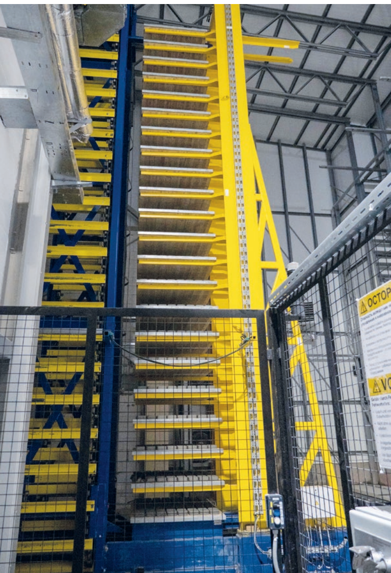
ciągły proces pracy dzięki wózkowi buforującemu Masa na linii suchej.
