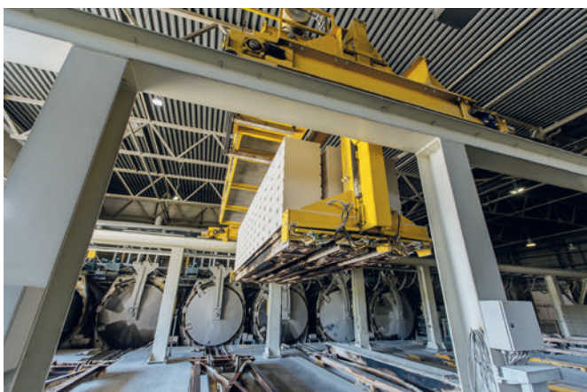
Impressioni: l'impianto per calcestruzzo cellulare Masa
