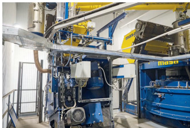
L'area destinata alla miscelazione comprende il miscelatore Masa S 350/500 (a sinistra) del calcestruzzo di rivestimento e il miscelatore Masa PH 1500/2250 per il calcestruzzo per lo strato interno
