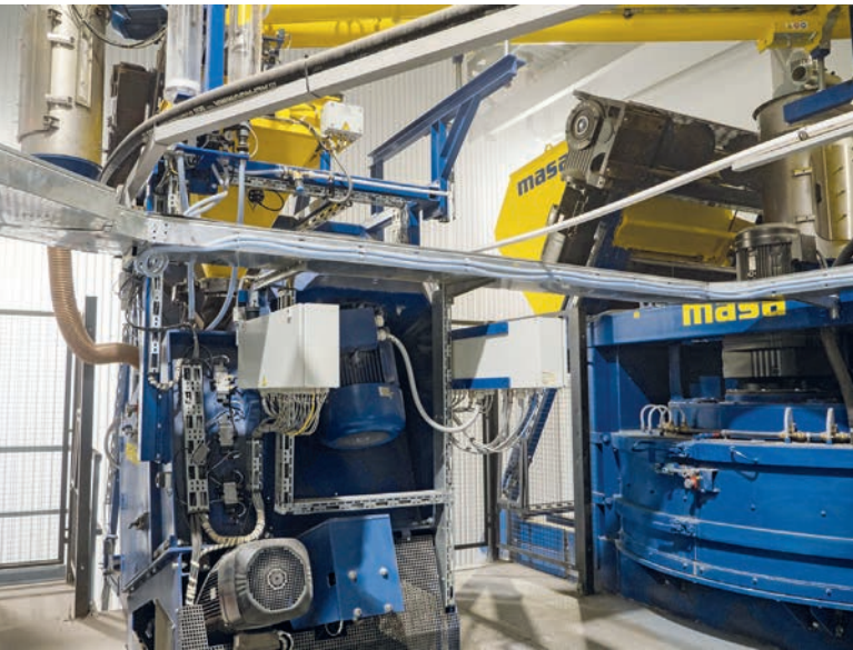
La zone de mélange comprend le malaxeur Masa S 350/500 (à gauche) pour le béton de parement et le malaxeur Masa PH 1500/2250 pour le béton de corps
