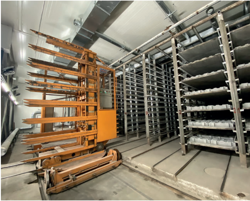
Vista de la cámara de curado con los sistemas de tuberías de Quadrix en el techo y en el suelo.
