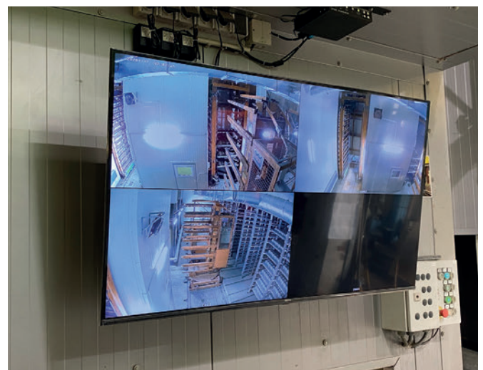
En una pantalla de 55" se pueden seguir los procesos dentro de la cámara de curado supervisada con una cámara.
