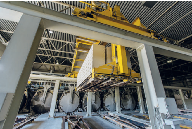
Vistas de la instalación de hormigón celular de Masa
