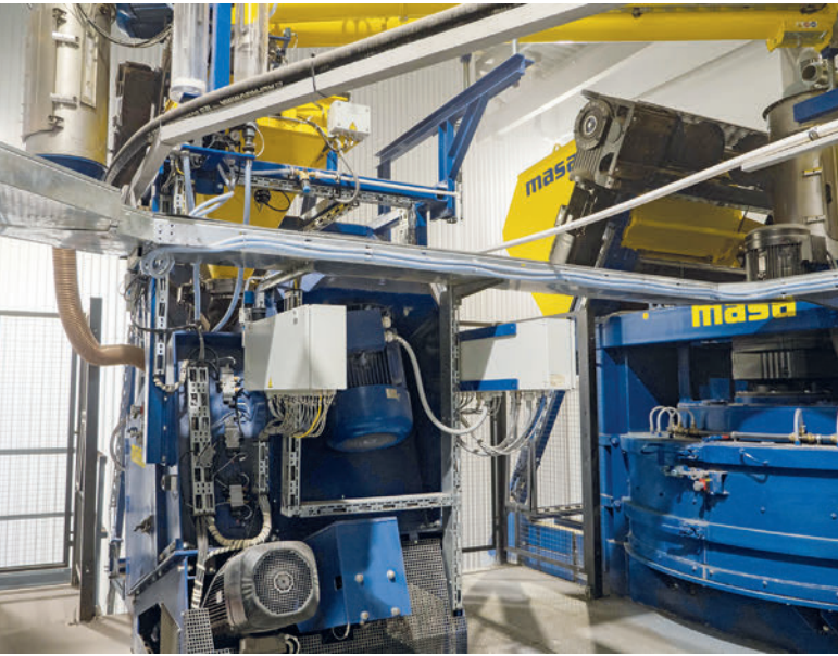
La zona de mezcla cuenta con la mezcladora Masa S 350/500 (a la izquierda) para el hormigón bicapa y la mezcladora Masa PH 1500/2250 para el hormigón monocapa
