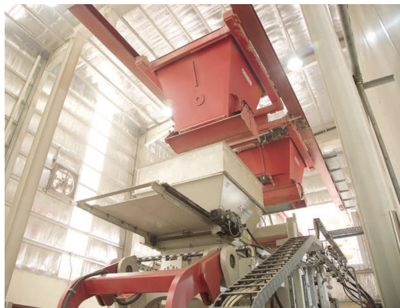
La cuba aérea doble transfiere el hormigón monocapa y bicapa a los correspondientes silos de almacenamiento de la máquina de producción de bloques.
