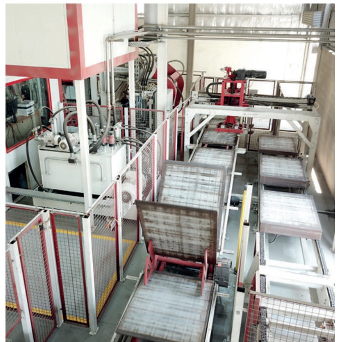
Querförderer mit Blechwender und Blechpufferbahn; im Hintergrund das Magnetstapelgerät
