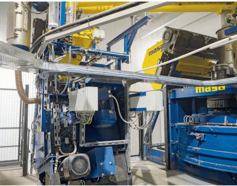
Der Mischbereich umfasst den Masa Mischer S 350/500 (links) für Vorsatzbeton und den Masa Mischer PH 1500/2250 für Kernbeton.
