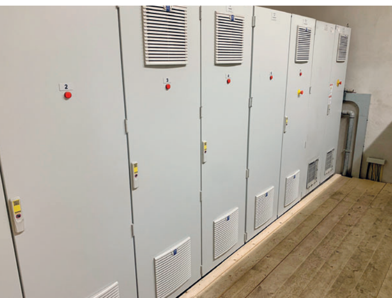
Все на своих местах в новых, кондиционируемых и защищенных от пыли помещениях шкафов управления
