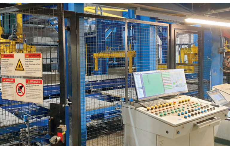
Новая панель управления для зоны обратной транспортировки и переформирования
