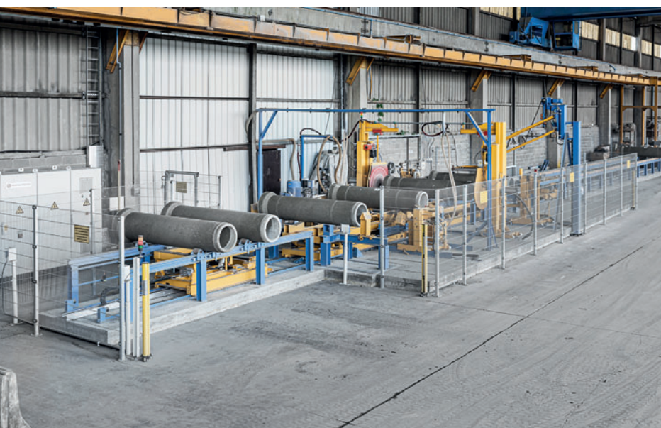
Еще один бетонный завод Beton De Clercq в Генте, Бельгия, использует линию для испытания труб от Prinzing Pfeiffer
