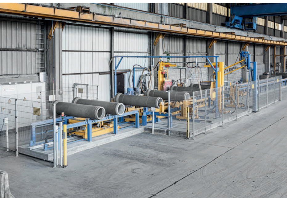
Con Beton De Clercq a Gand, in Belgio, un altro stabilimento di prefabbricazione si affida a una linea per il controllo tubi di Prinzing Pfeiffer.
