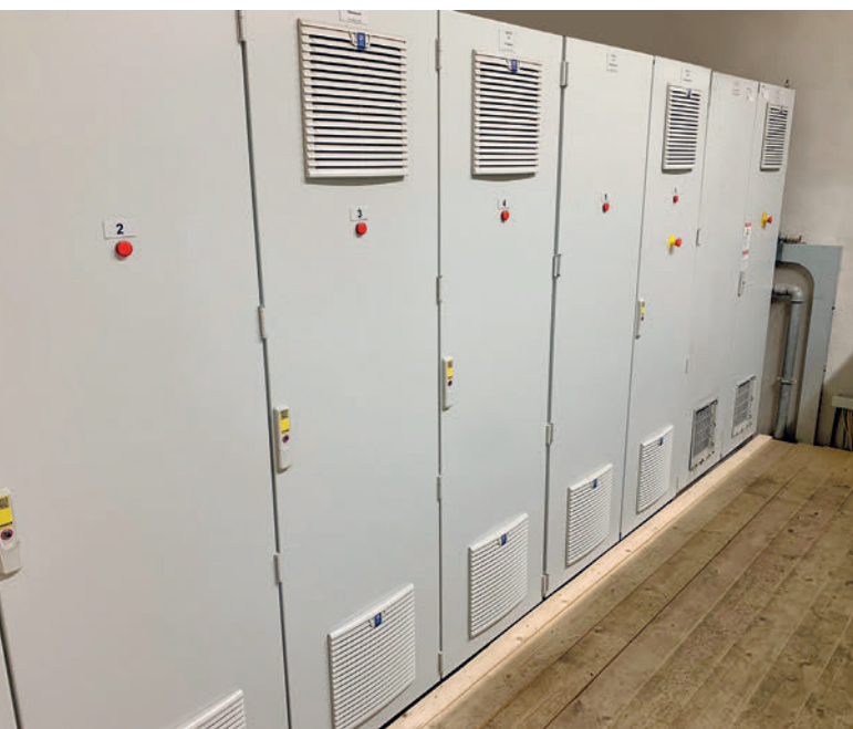
Tutto al suo posto nei nuovi vani in cui sono collocati i quadri elettrici ad armadio climatizzati e protetti dalla polvere
