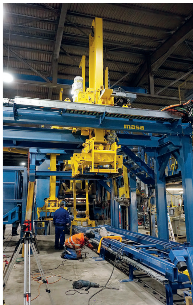
Durante la fase di ristrutturazione: montaggio del trasporto di ritorno, dell'unità di spostamento strati III e IV e del Cuboter.
