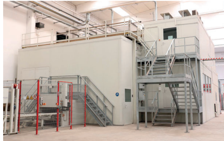
Vano di insonorizzazione macchina, controllo e dei quadri di comando ad armadio
