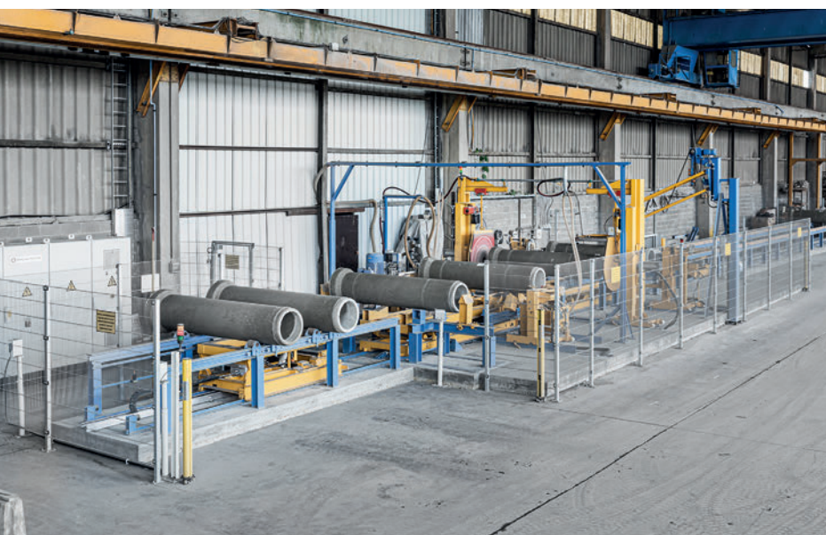
L'usine de béton de Béton De Clercq à Gand (Belgique) s'appuie désormais elle aussi sur une ligne de test de tuyaux de Prinzing Pfeiffer.
