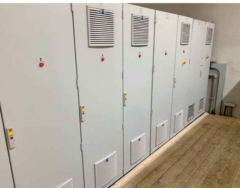
Tout est à sa place dans de nouveaux locaux des armoires de distribution, climatisés et protégés contre la poussière
