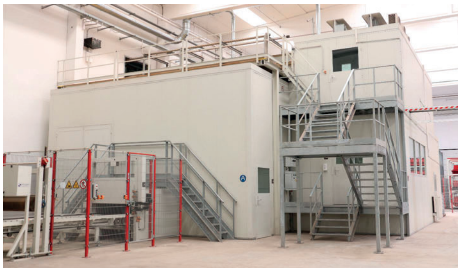
Insonorisation de la machine, salle de contrôle et local des armoires de distribution
