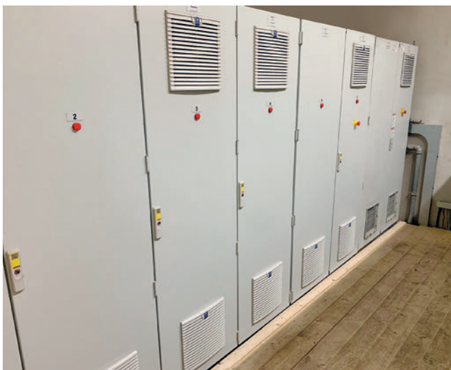
Todo en su lugar en salas de armarios de distribución nuevos, climatizados y protegidos contra el polvo
