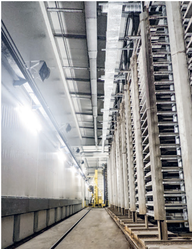
Los canales del interior proporcionan un clima adecuado dentro de la cámara
