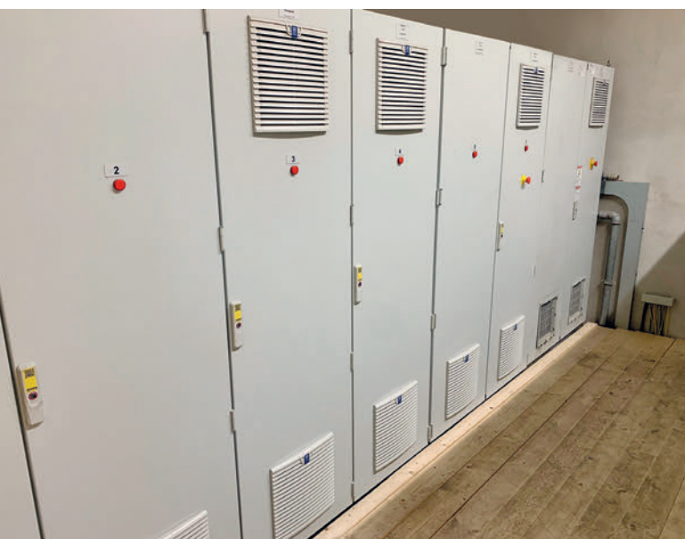
Alles an seinem Platz in neuen, klimatisierten und staubgeschützten Schaltschrankräumen
