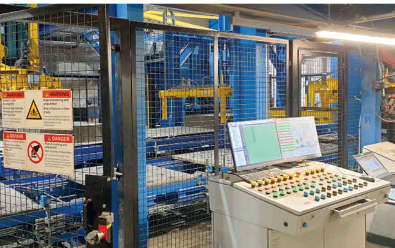
Das neue Steuerpult für den Bereich Rücktransport und Umformierung
