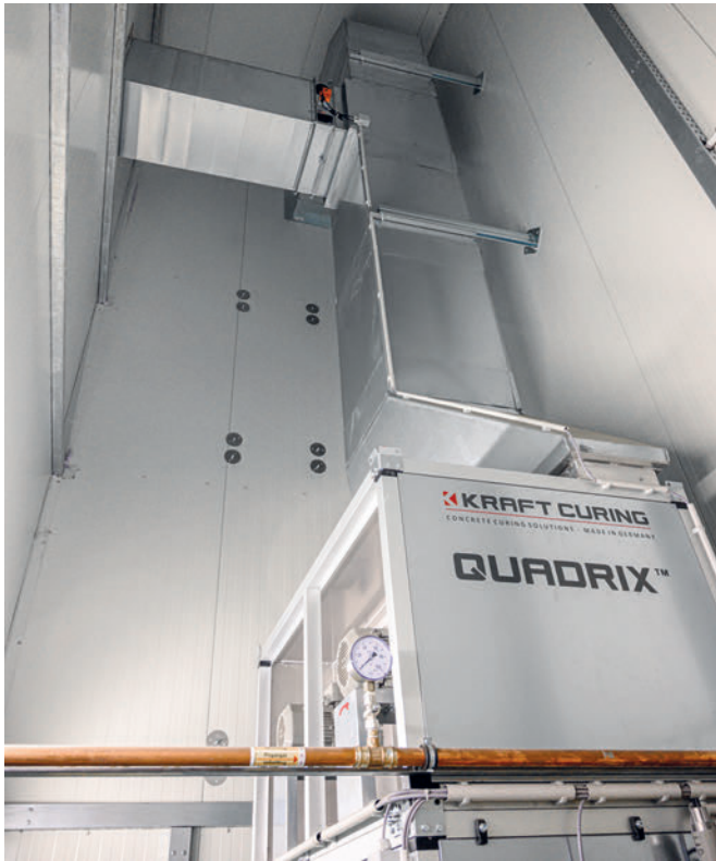
Ein Technikraum erleichtert den Wartungszugang.
