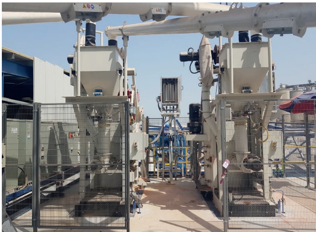
Węzeł betoniarski z dwiema mieszarkami do betonu licowego typu SM400.
