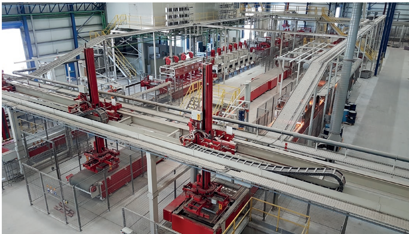
Linia uszlachetniania wyrobów betonowych.
