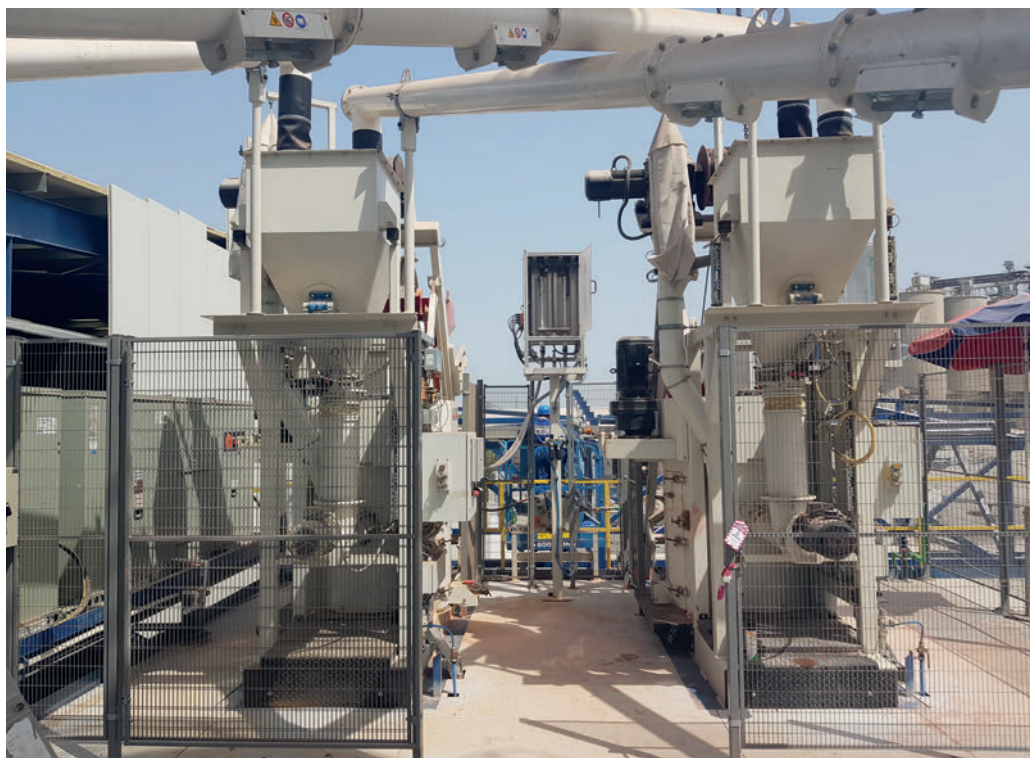
Impianto di betonaggio con due miscelatori per il calcestruzzo di rivestimento SM400
