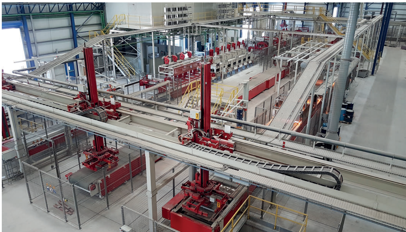
Impianto di trattamento
