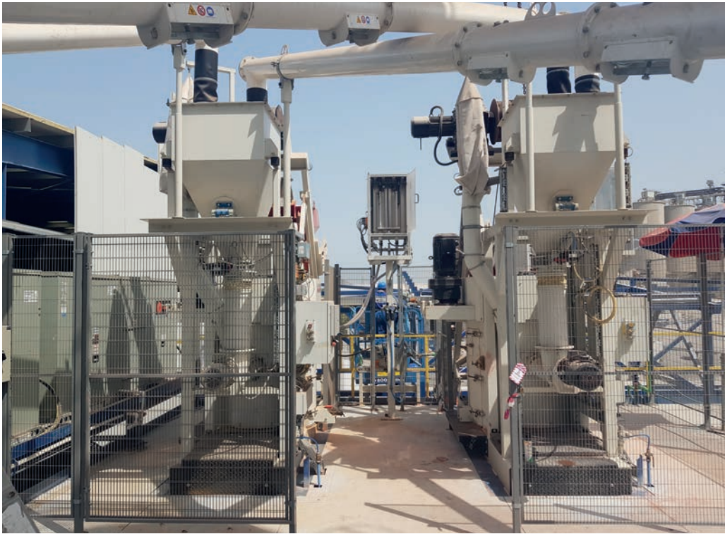
Installation de mélange avec deux malaxeurs pour béton de parement SM400
