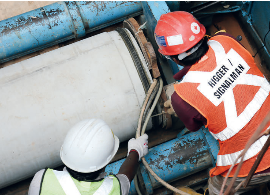
Einbau von Perfect-Pipe-Vortriebsrohren im ersten derart realisierten Projekt in Singapur - es wurde darüber bereits in BWI 2/2016 berichtet.
