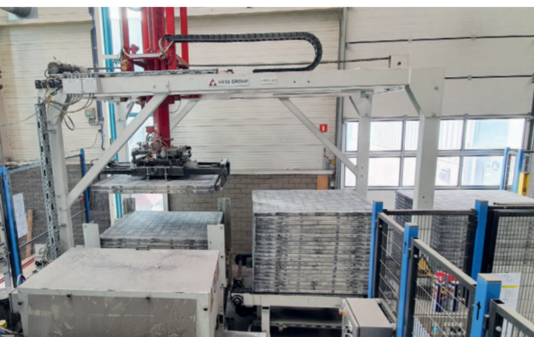
Буферный конвейер для производственных поддонов с подъемным краном и зоной хранения поддонов
