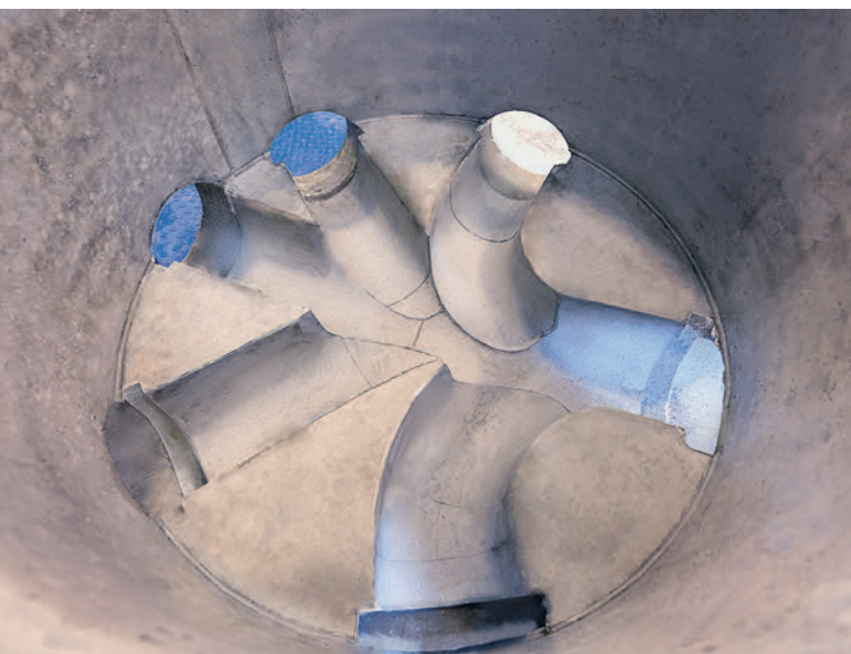
Precisione costruttiva di fondi per pozzetti con canali di scolo e raccordi dei tubi
