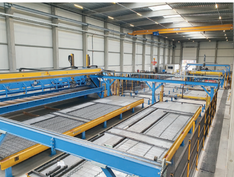
Vista complessiva dell'impianto con lavorazione automatica dell'acciaio d'armatura e robot di cassetta completamente automatizzata, dispositivo di pulizia pallet compreso.
