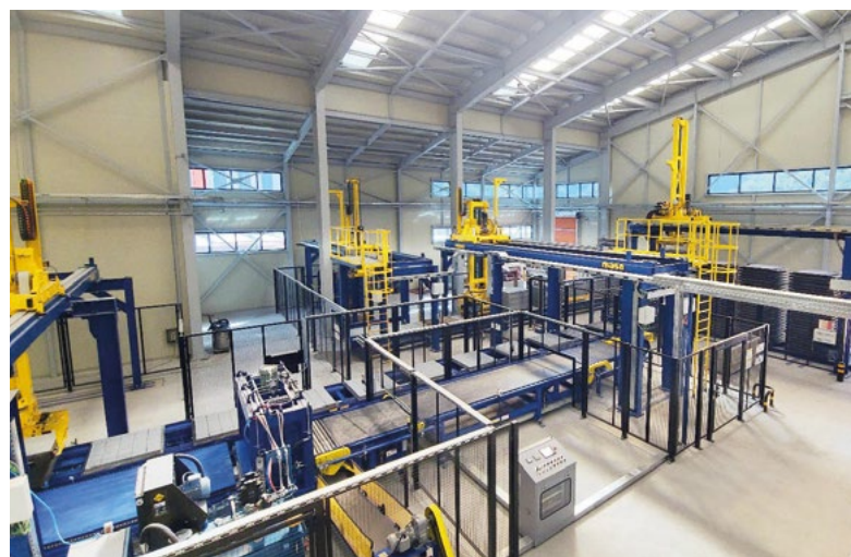
Un bref aperçu : côté sec, zone d'emballage et transport transversal.
