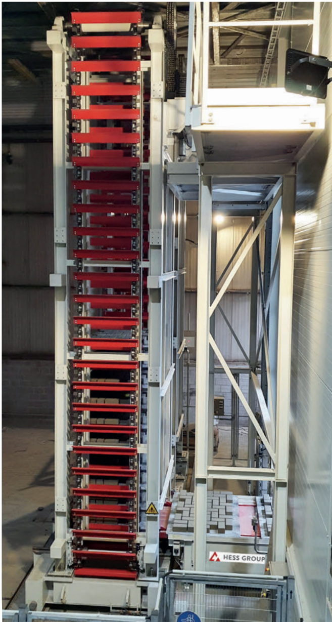
Sistema de ascensor; foto tomada desde el lateral de la cámara de curado
