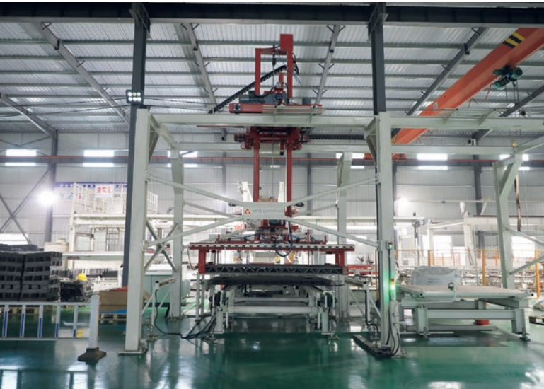
Fig. 11: Système de palettisation avec capteurs de position pour une manutention efficace des aciers d'armatures
