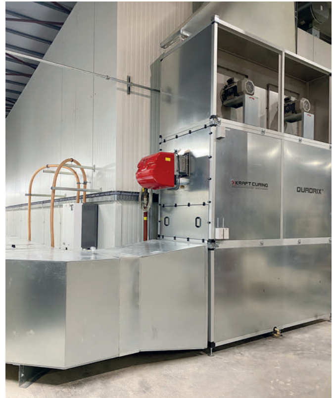
El ambiente ideal del interior de la cámara de curado se consigue gracias a la instalación de curado de hormigón Quadrix Ultra de Kraft Curing Systems.
