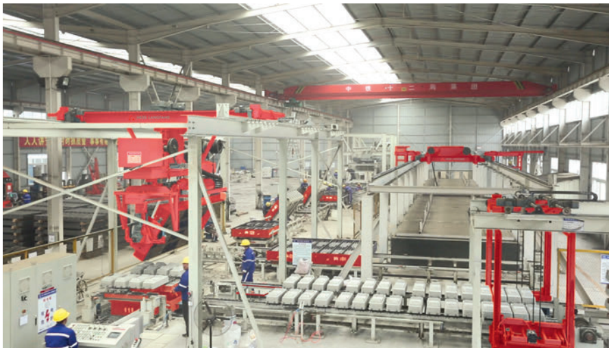
Fig. 2: Moderna instalación de carrusel: primer proyecto de China Railway 12 th Bureau, Lanxin Daban City
