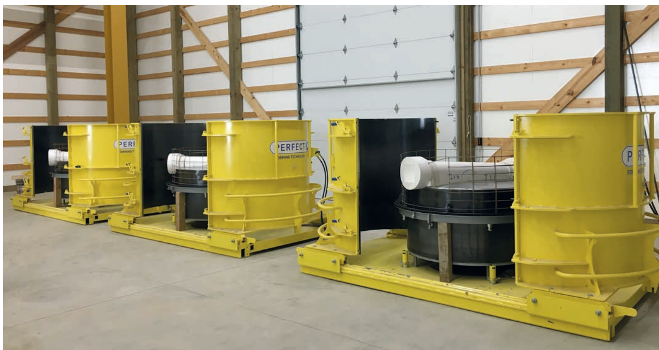
Gli stampi costituiti da canali di scolo EPS e armatura in acciaio sono pronti per il riempimento con calcestruzzo autocompattante
