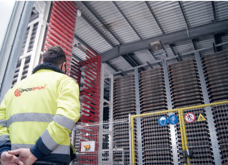
El descensor y el carro multiforca se encuentran dentro de la estantería de cámara grande de Rotho con el sistema de calefacción Pro Cure
