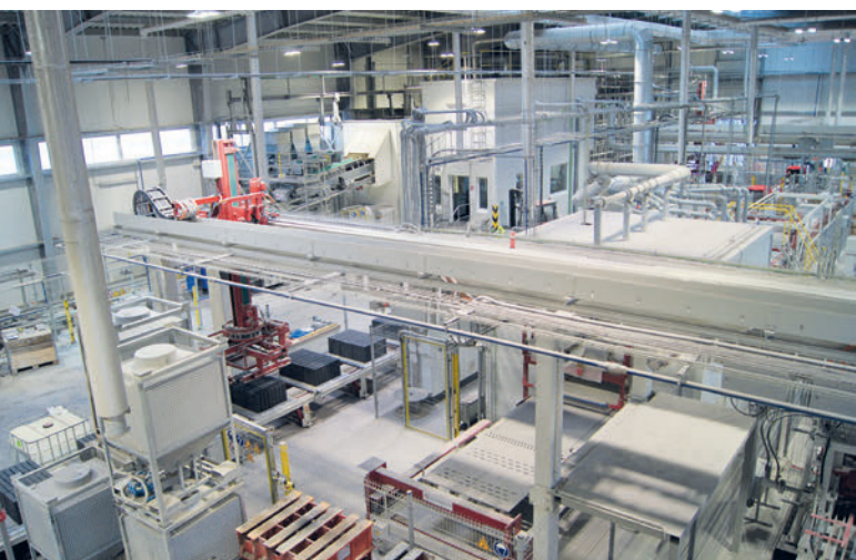
Anlagenübersicht: ganz links die Nassseite, in der Mitte die Trockenseite und rechts die Veredelungslinien
