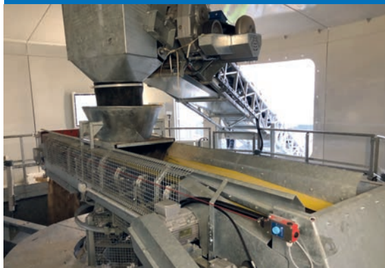
Итальянский производитель оборудования Imer Group поставил БСУ для нового завода по производству сборных железобетонных изделий Pekabex в Гданьске
