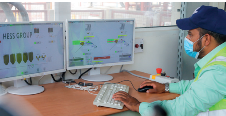
System sterowania węzłem betoniarskim.
