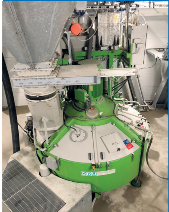
Węzeł betoniarski jest wyposażony w mieszarkę planetarną ORU MS 2.250/1.500S.
