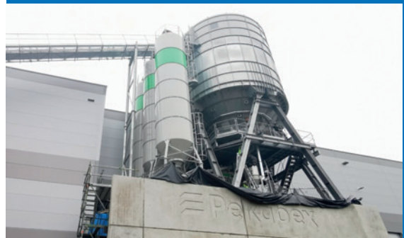
Taśmociągiem o długości 70 m kruszywo jest dostarczane do zasobnika, w którym zamontowano obrotowy taśmociąg rozdzielający kruszywo na poszczególne komory.
