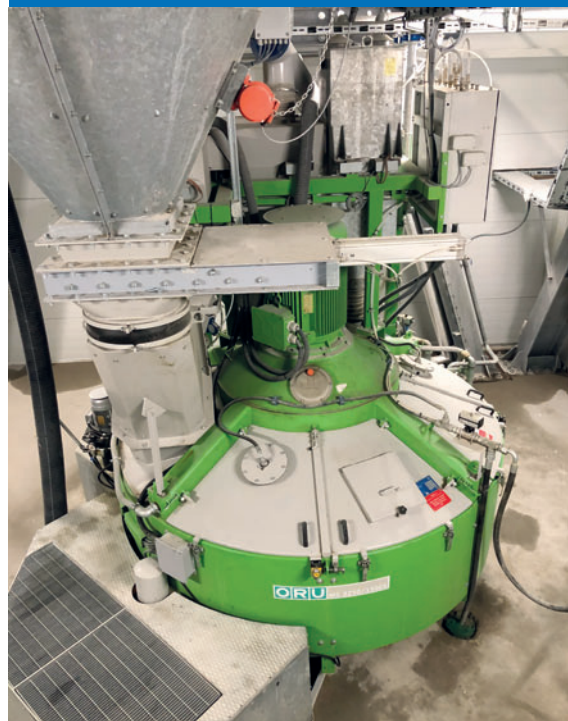
Die Mischanlage ist ausgerüstet mit einem Planetenmischer ORU MS 2.250/1.500S.
