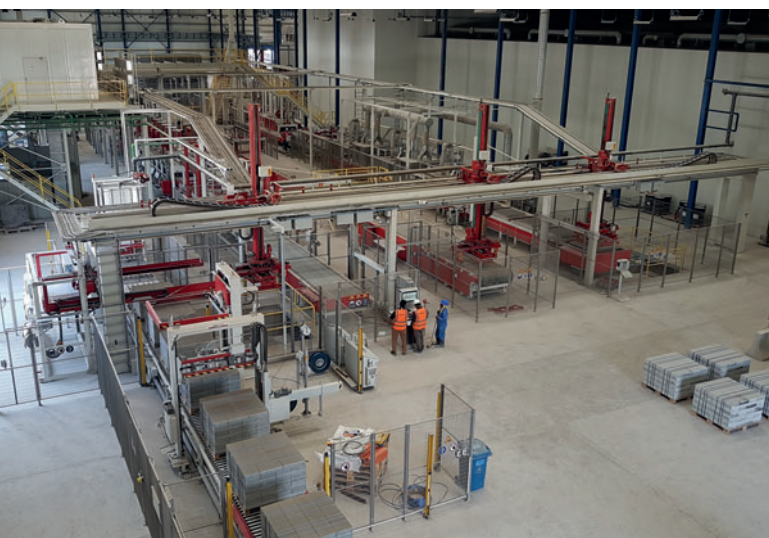
Impianto di trattamento SR Schindler
