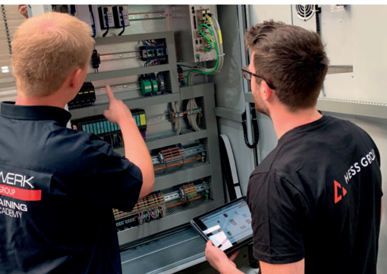
Изучение принципов работы электрошкафа
