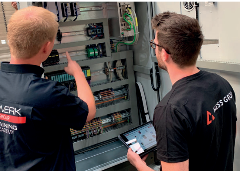
Introducción en el funcionamiento del armario de distribución
